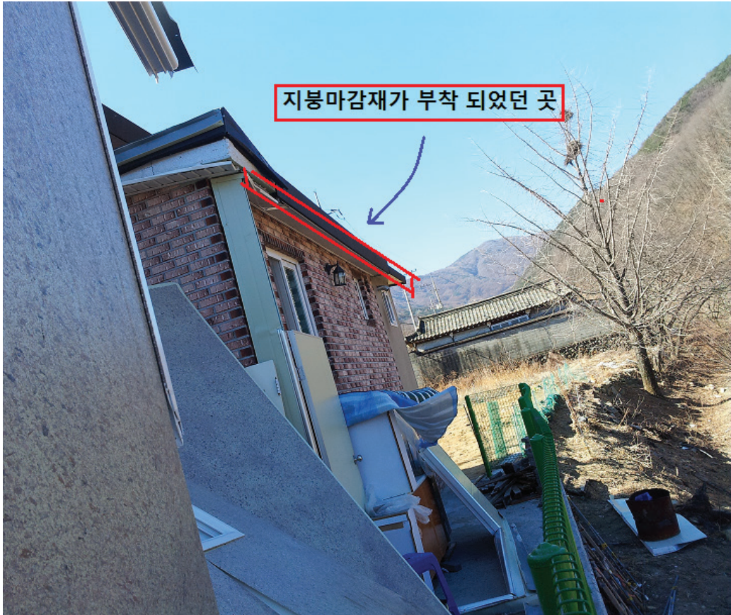
붙임 13. 사고현장 주택 사진
