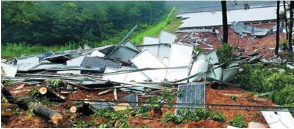
사고 장소 : 밀양시 산외면 금곡리 746-1, 금곡 태양광 발전소
